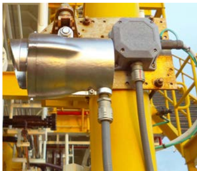
Detecção de vazamento de gás e chama
