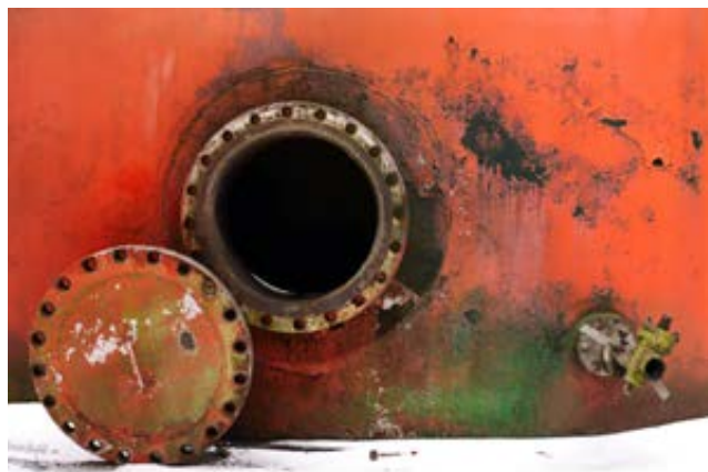
A entrada em espaços confinados pode ser extremamente perigosa
