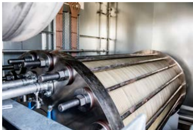
Eletrolisador de hidrogênio da McPhy para 0,5 MW, 200 metros cúbicos por hora. Copyright RAG & Karin Lohberger Photography.
