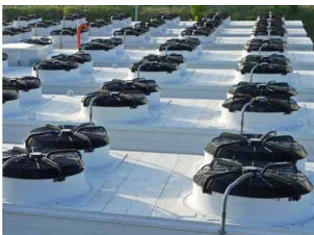
Sistema da evaporadores de refrigeração com amônia
