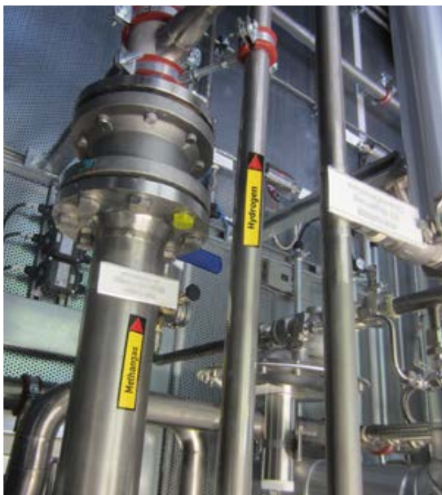
Painel de gás hidrogênio. Direitos autorais TÜV SÜD.
